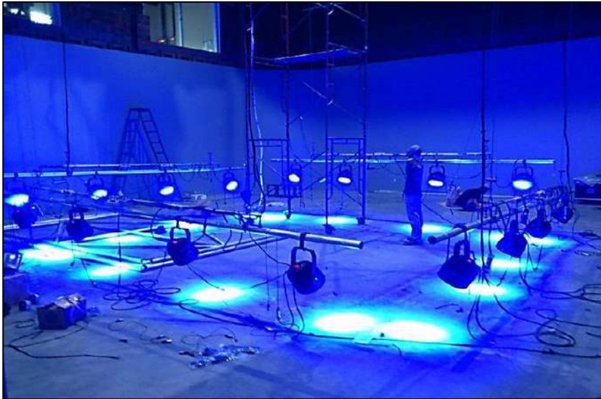
Gambar 229. Pemasangan Semua Lighting PAR LED pada Rigging (Doc Arya. 2015)
