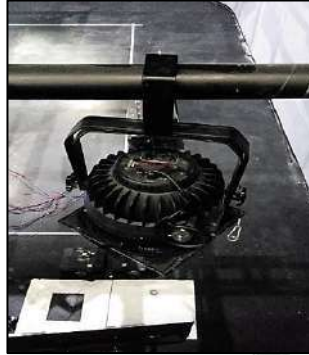
Gambar 227. Pemasangan Lighting pada Rigging .
