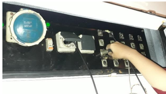
Gambar 4.18, port untuk kabel didalam mobil SNG, sumber: dokumen pribadi
