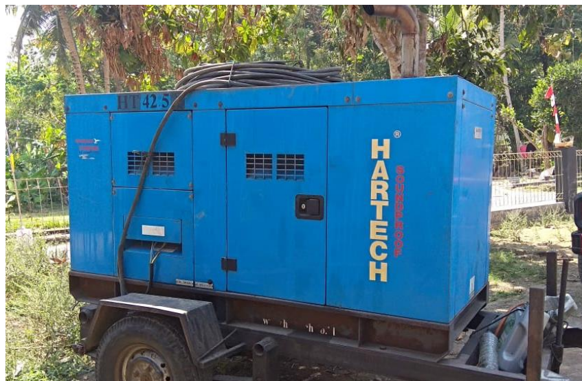
Gambar 52. Genset Sumber: dokumentasi pribadi DC Pro
